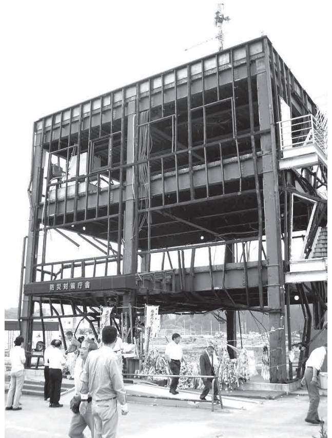
津波で全壊した防災対策庁舎
